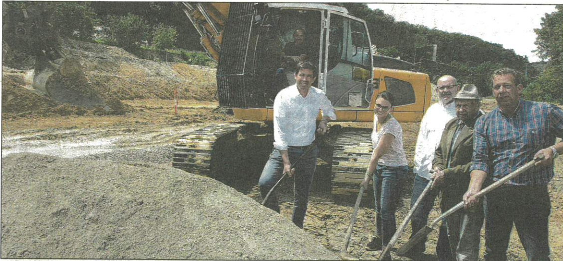
Offizieller Spatenstich zum Bau von 18 Reihenhäusern und Geschäftsgebäude: Bürgermeister Patrick Grossmann, Architektin Kathrin Wutzlhofer, Hans-Peter Weinzierl, Jakob Weinzierl und Armin Zeiler.
